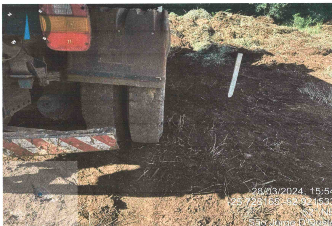
Foto 33: estaca 03 Rua dos Girassóis, bordo direito – sem deformação
