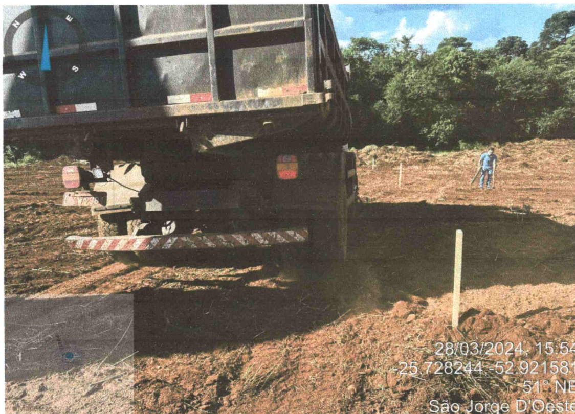
Foto 32: estaca 01 Rua dos Girassóis, bordo direito – sem deformação
