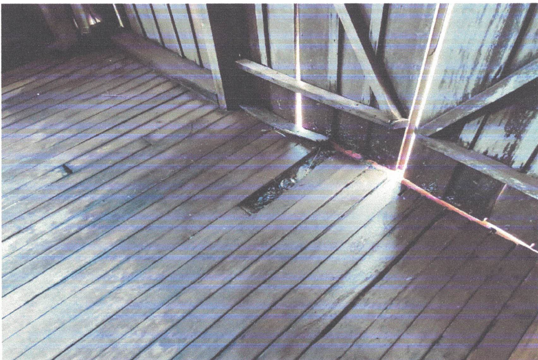
Foto 04: parte do piso de madeira comprometido
